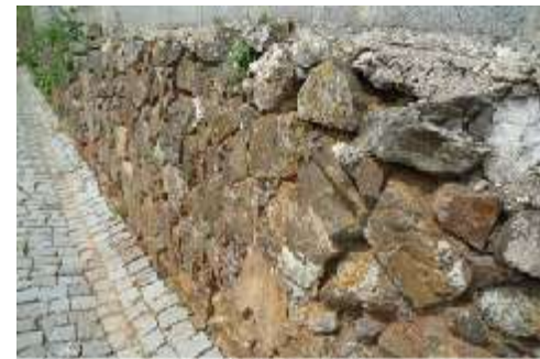
Fig. 3 - Muro (rua Inácio Cabrita) construído em alvenaria de pedra natural (vários tipos de rochas locais – grauaque, corneana, sienito nefelínico).
